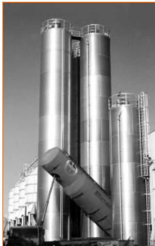
A műanyag alapanyag szállítása tartályautóban, tárolása tárolósílóban történik.
